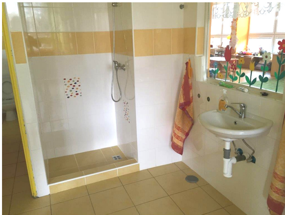
Vzor- sprcha - již v minulosti opravené sociální zařízení v pavilonu A
