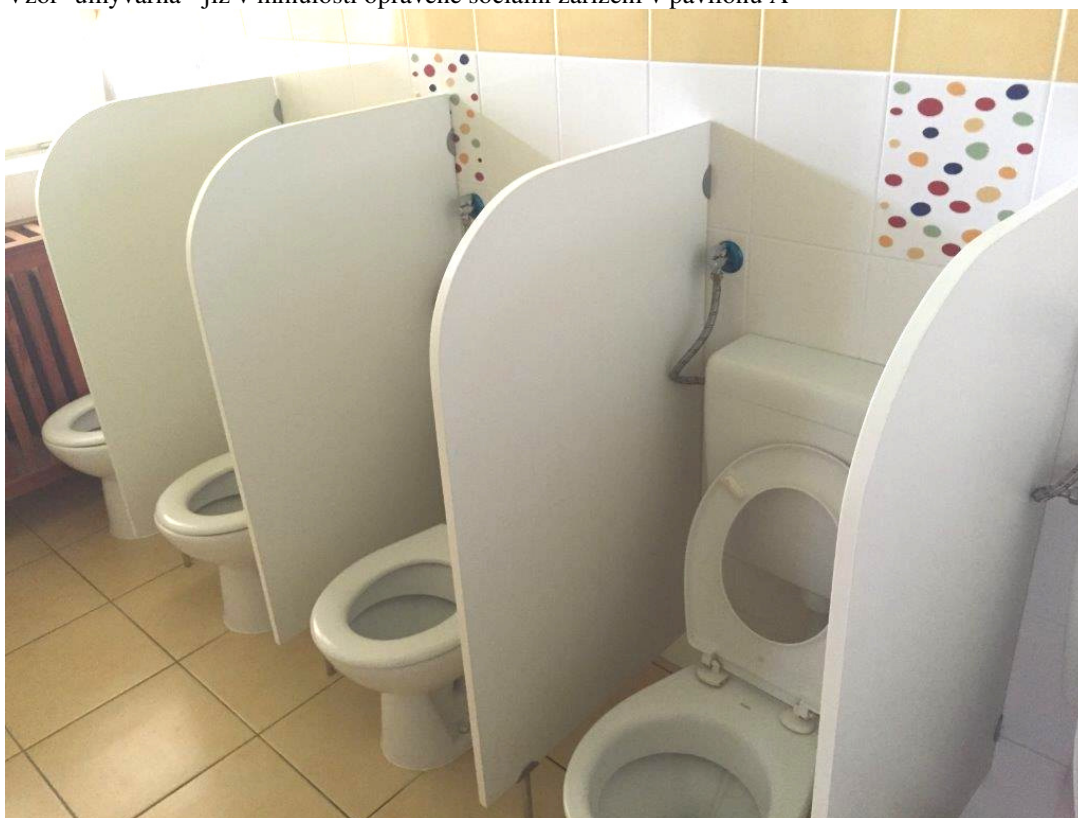
Vzor- WC - již v minulosti opravené sociální zařízení v pavilonu A
