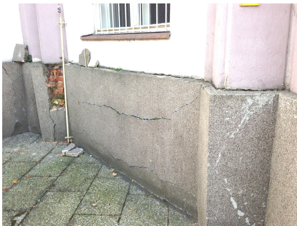
stávající rozpadlý sokl hlavní budovy divadla
