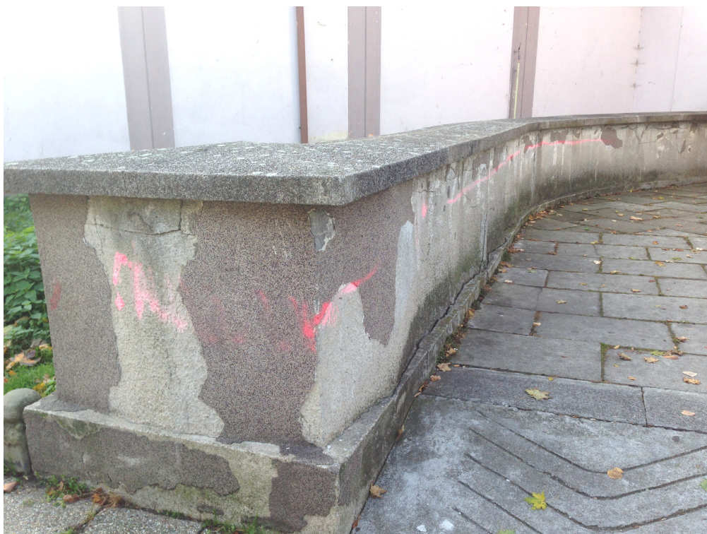
zídky bočních vstupů s narušenou omítkou - 2kusy
