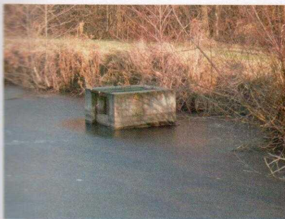
betonový otevřený požerák
