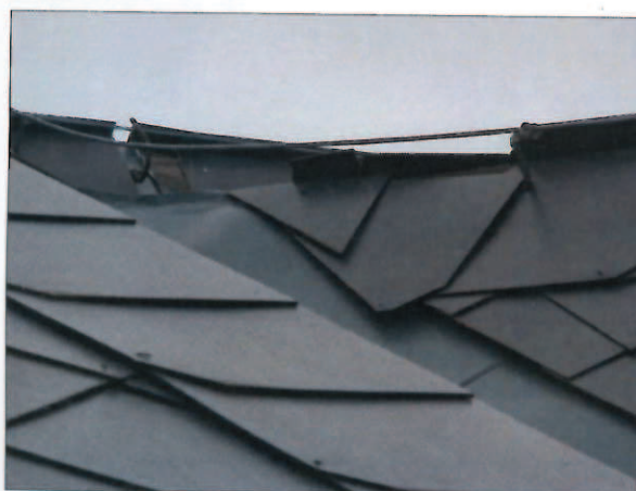
obr /14/ Pohled na uvolněné desky u hřebce střechy
