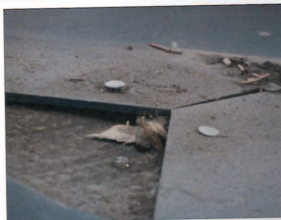
obr /25/ Detail poškození střešní desky – uvolněné kotvicí prvky
