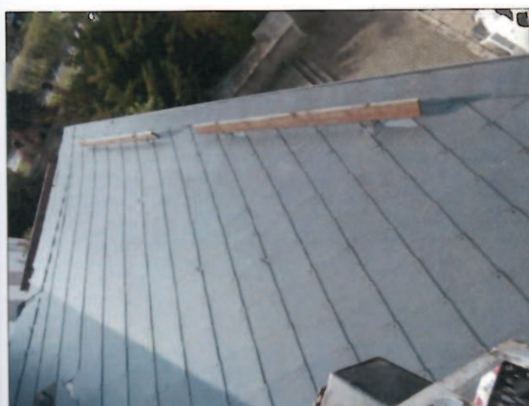
obr /10/ Pohled na část nižší střechy u okapu – poškozené desky u zachytávače a v ploše
