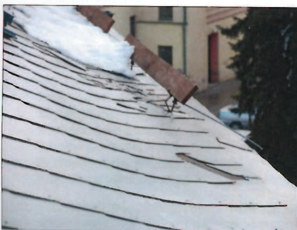
obr /44/ Poškození střešní krytiny u okapu střechy [12]
