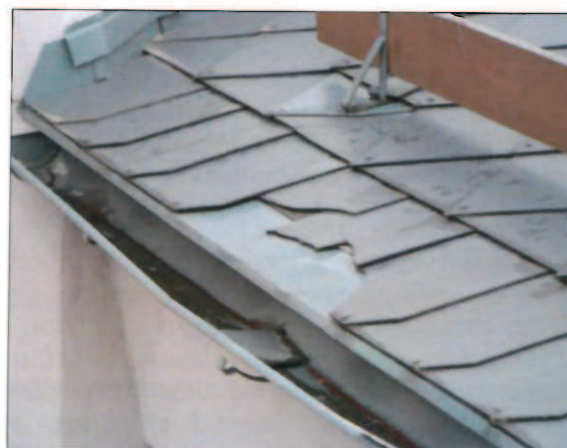
obr /47/ Poškození střešní krytiny u okapu střechy [12]
