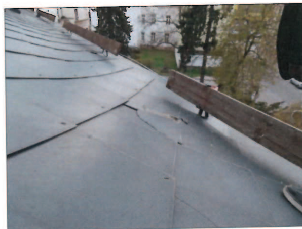
obr /23/ Detail poškození střešní krytiny v místě ukotvení sněhového zachytávače
