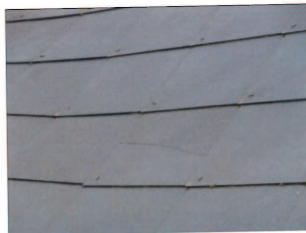
obr /21/ Detail poškozené desky v ploše střechy
