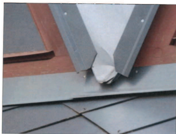
obr /17/ Detail poškození úžlabního oplechování
