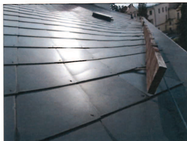
obr /9/ Pohled na poškození střešní krytiny v místě zlomu (změny sklonu) střešní krytiny
