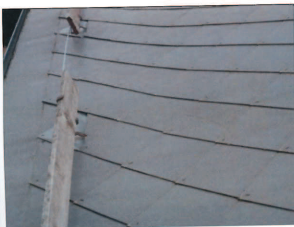
obr /20/ Pohled na část střechy u okapu – poškozené desky u zachytávače a v ploše střechy
