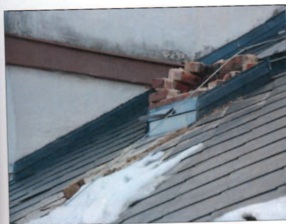
obr /40/ Pohled na destrukci komínového tělesa [12]
