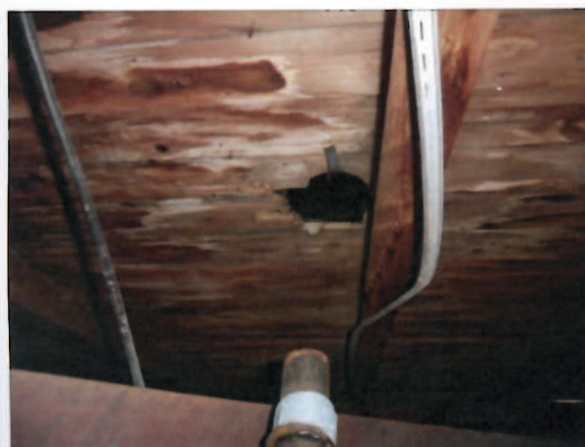
obr /32/ Pohled na poškozené dřevěné bednění, stopy od zatékání
