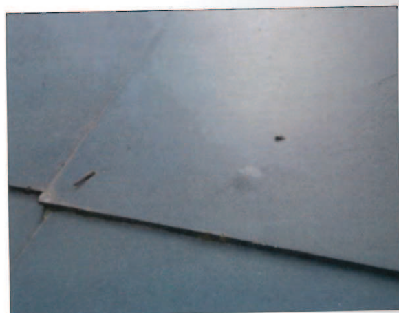
obr /27/ Poškození střešní krytiny od kotvicích prvků spodní desky
