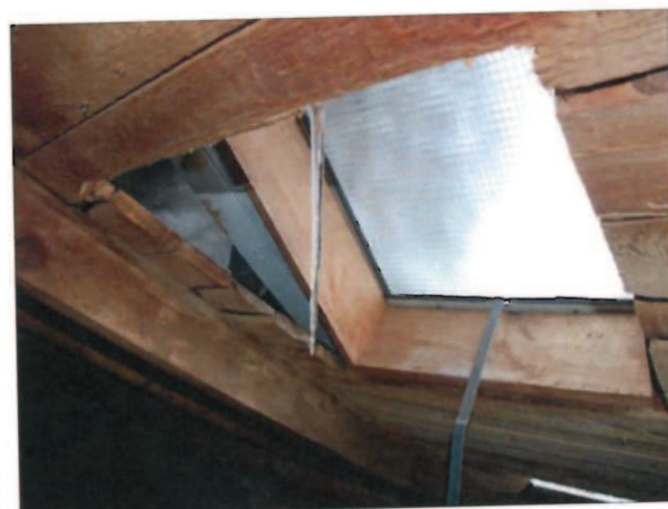
obr /39/ Pohled na poškození střešního výlezu z vnitřní strany [12]
