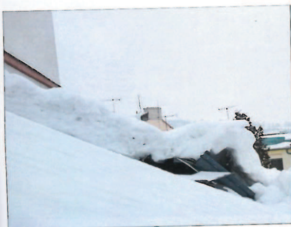
obr /38/ Poškození střešního výlezu vlivem skluzu sněhu [12]
