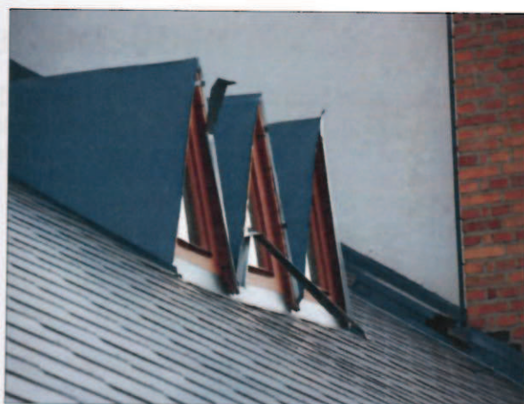
obr /42/ Pohled na střešní vikýře – poškozené čelní lemování [12]
