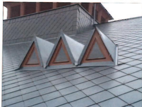
obr /15/ Pohled střešní vikýře – poškozené čelní lemování
