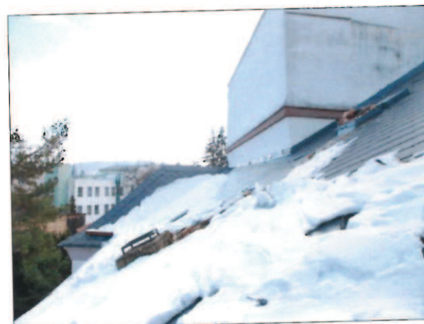
obr /41/ Pohled na destrukci komínového tělesa [12]
