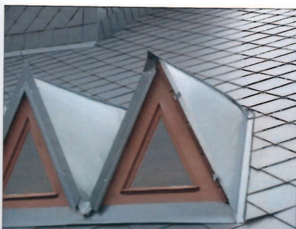
obr /16/ Detail poškození čelního lemování
