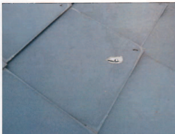
obr /30/ Poškození střešní krytiny od kotvících prvků spodní desky
