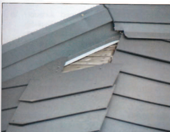
obr /46/ Absence střešní krytiny (pod krytinou není podkladní asfaltový pás) [12]
