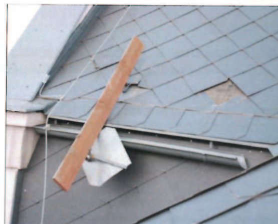
obr /43/ Poškození sněhového zachytávače [12]
