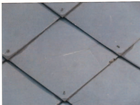
obr /7/ Pohled na poškození střešní krytiny
