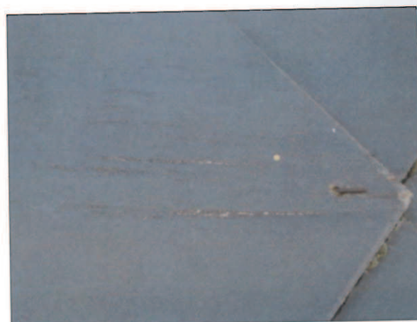
obr /29/ Detail mechanického poškození střešní krytiny
