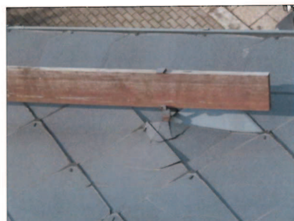
obr /11/ Detail poškození střešní krytiny v místě ukotvení sněhového zachytávače
