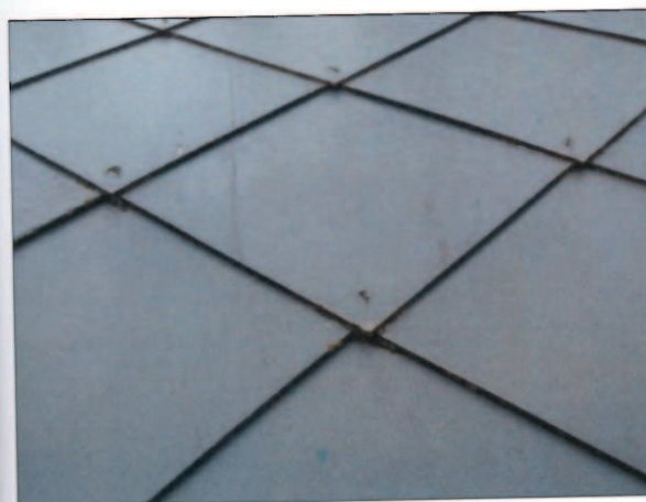
obr /28/ Mechanické poškození střešní krytiny
