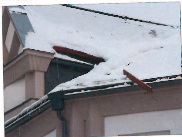
obr /37/ Pohled na objekt v době zásahu při odklízení sněhu [12]
