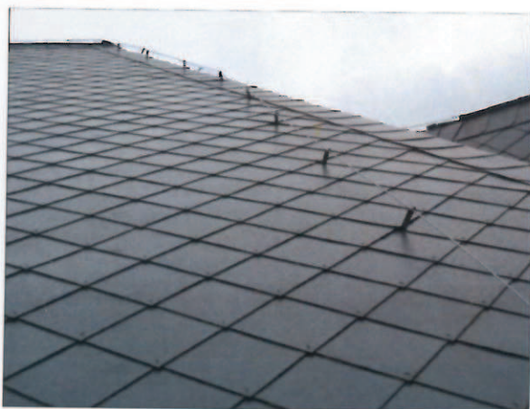
obr /12/ Pohled na deformované držáky bleskosvodné ochrany
