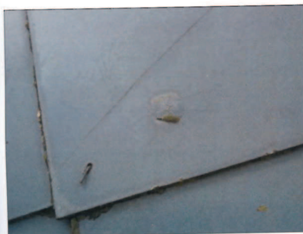
obr /26/ Poškození střešní krytiny od kotvicích prvků spodní desky
