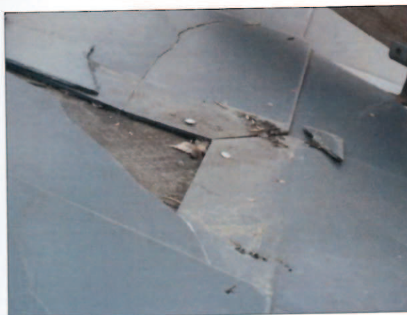
obr /24/ Detail poškození střešní desky
