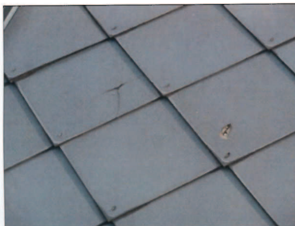
obr /8/ Pohled na poškození střešní krytiny
