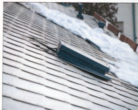
obr /45/ Poškození střešní krytiny nad střešním výlezem [12]
