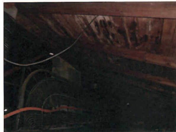
obr /33/ Pohled na poškozené dřevěné bednění, stopy od zatékání
