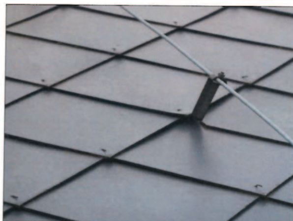
obr /13/ Detail deformace držáku bleskosvodné ochrany
