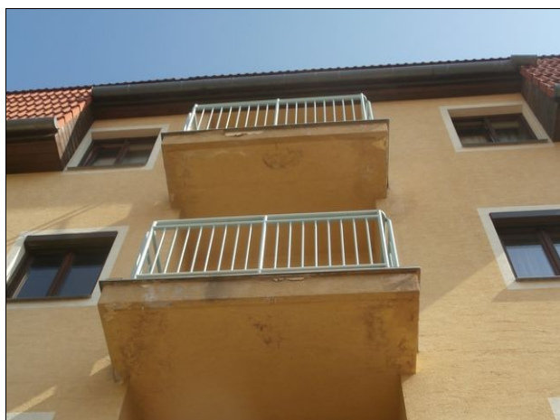
obr. /8/ Pohled na degradaci povrchové úpravy u okapové části balkónu, stopy zatékání
