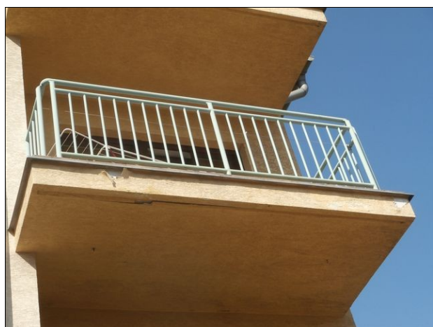
obr. /6/ Pohled na degradaci povrchové úpravy u okapové části balkónu
