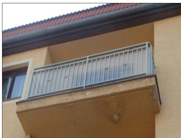
obr. /7/ Pohled na degradaci povrchové úpravy u okapové části balkónu, stopy zatékání
